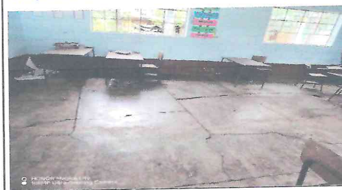
Foto 5: Tejido de concreto es mal estado
