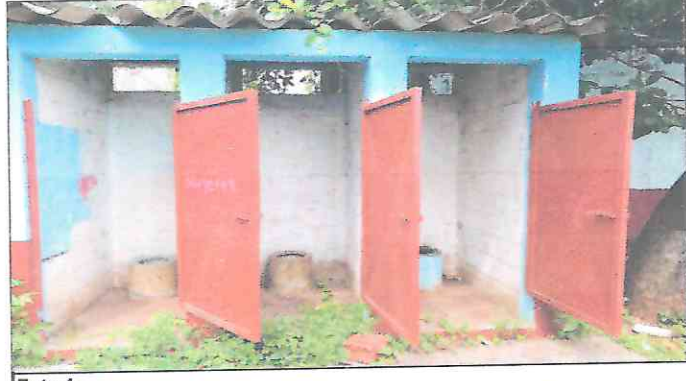
Foto 4: Sanitarios en mal estado
