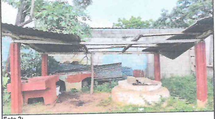
Foto 2: Lamina en mal estado
