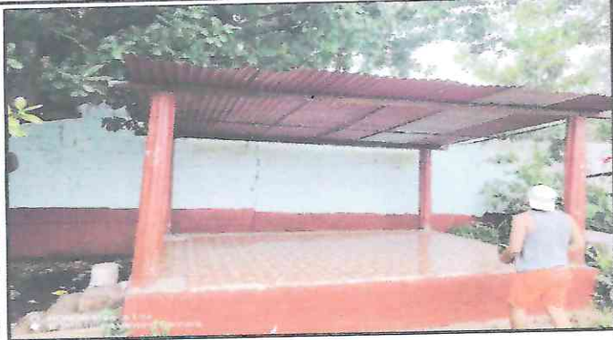
Foto 1: Lamina en mal estado
